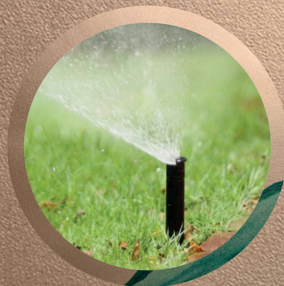
Reaproveitamento de água de chuva para irrigação automática das áreas comuns.
